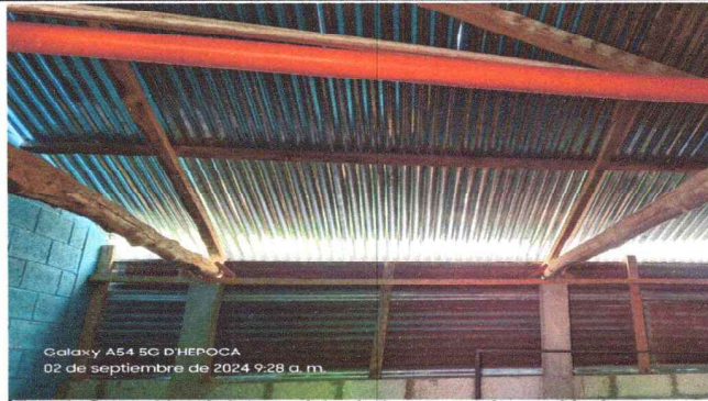
Foto 2: Otra evidencia interna del aula 1 que necesita cambio de entechado.
