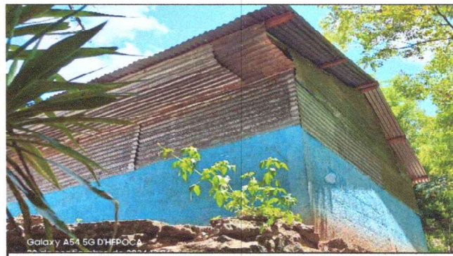
Foto 4: Otra evidencia del aula 1 que necesita complemento de pared de concreto.
