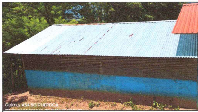
Foto 3: Otra evidencia del aula 1 que necesita cambio de entechado.
