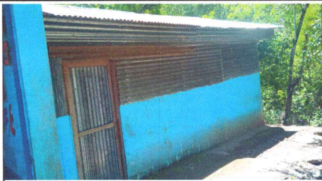
Foto1: Aula 1 que necesita cambio de entechado y complemento de pared de concreto.
